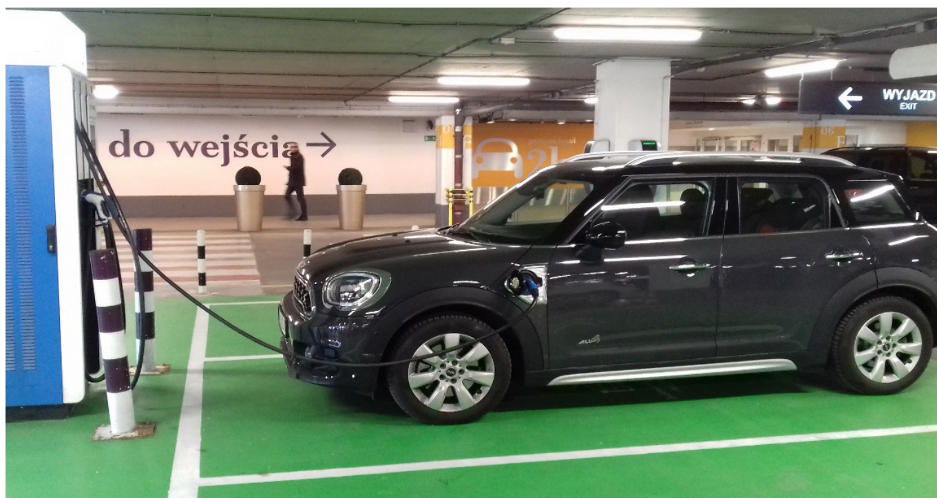
Zdjęcie 2. Stacja ładowania na parkingu galerii handlowej
